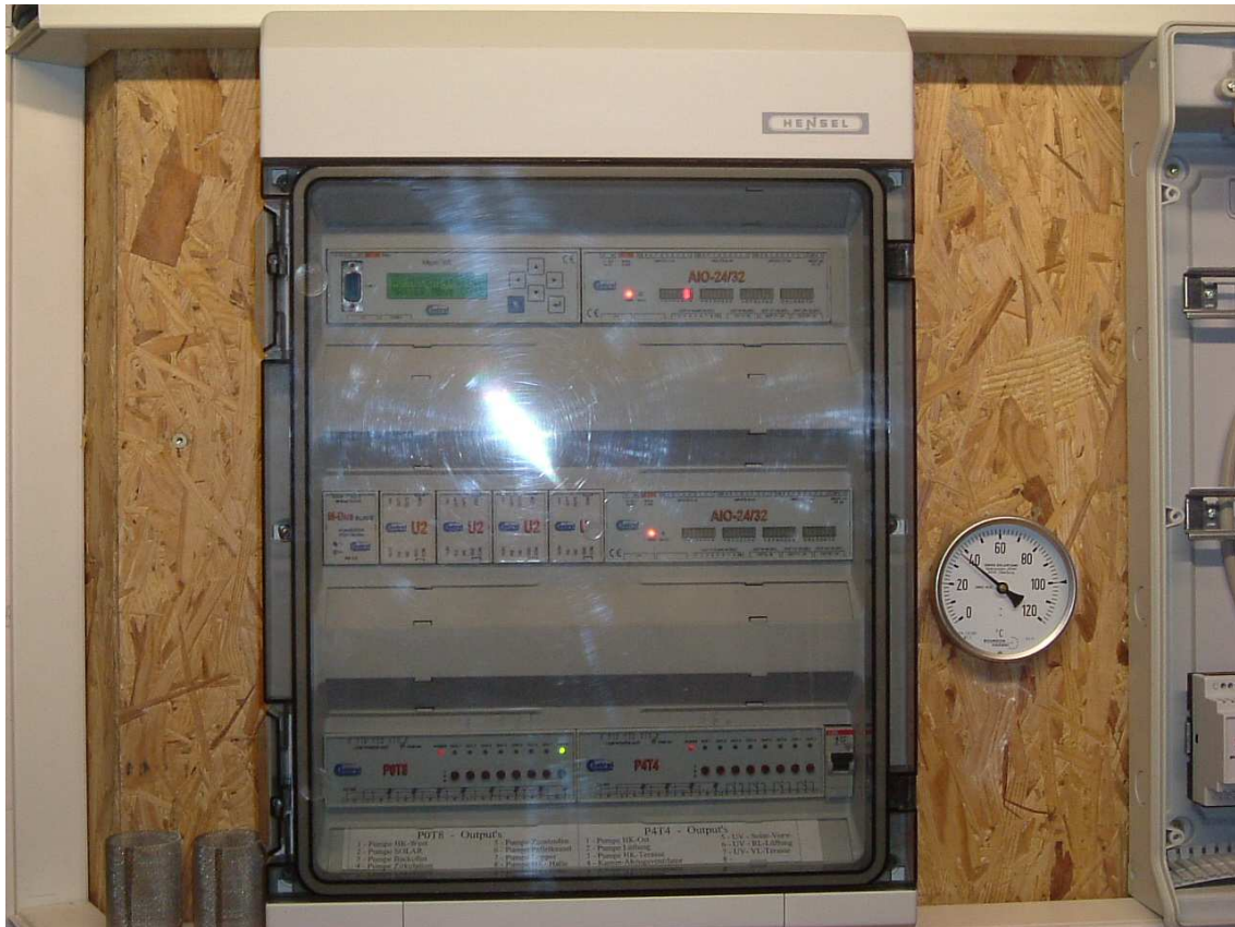
Abbildung 30 Systems Control Micro XXL; Zentrale Regeleinheit im Sonn-Zentrum /31/
