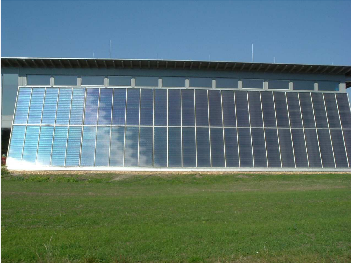
Abbildung 20: Fassadenkollektor des Sonnen-Zentrums /23/
